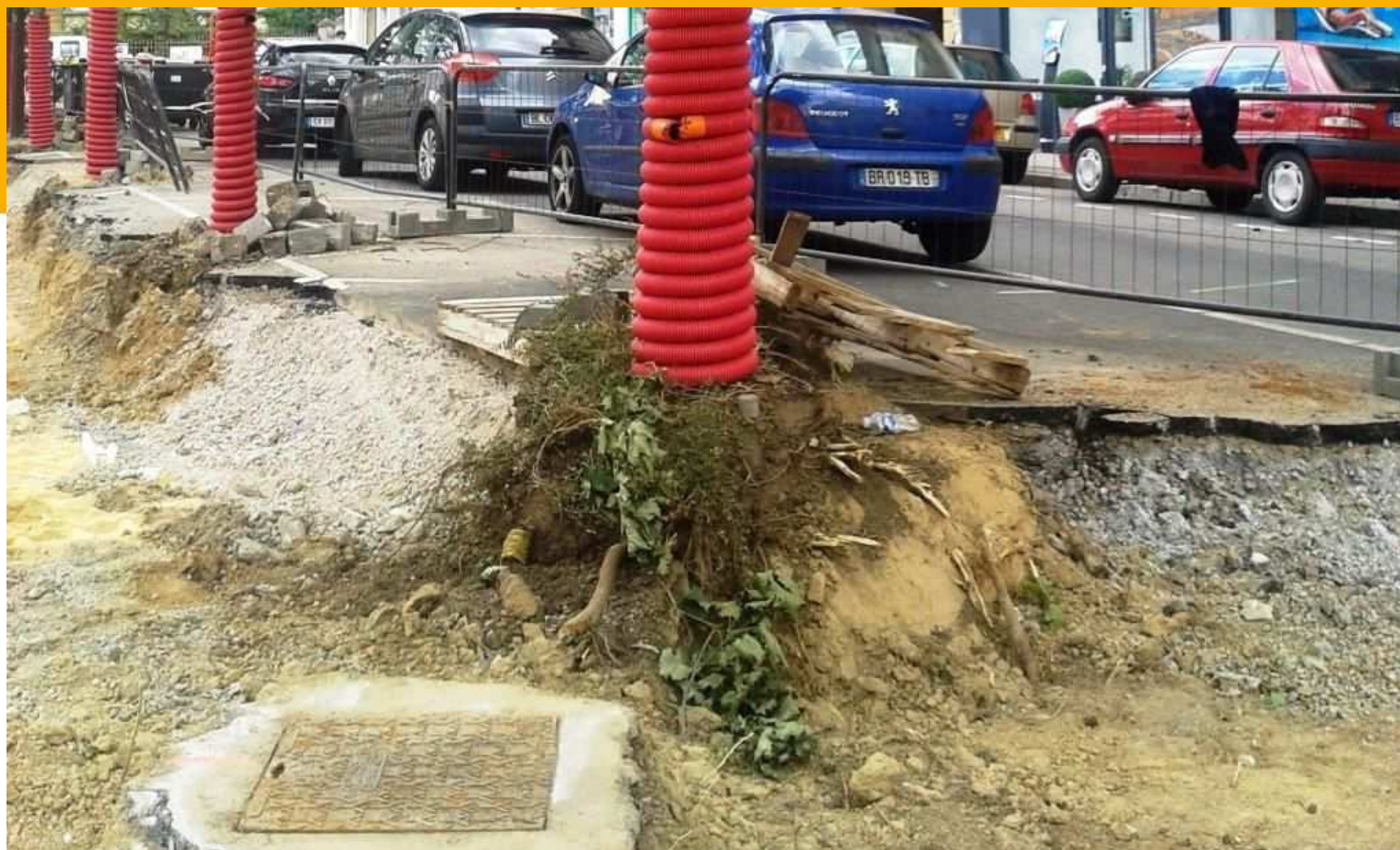
Dégâts sur racines – rue Leclerc de Hautecloque, septembre 2017
