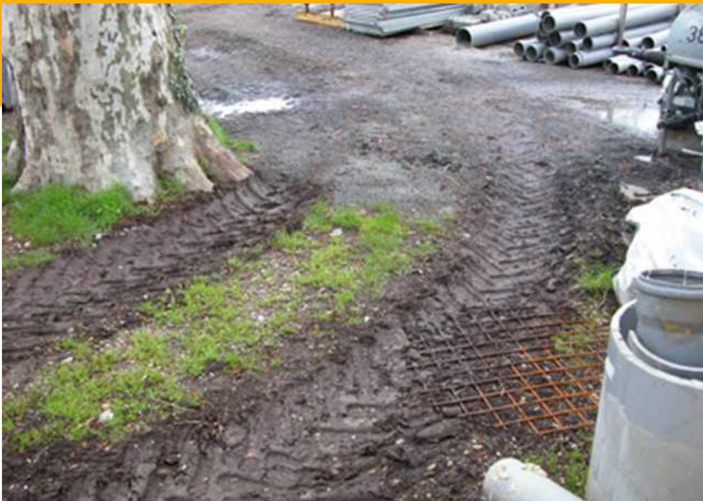
Tassement du sol du fait du passage d'engins de chantier
