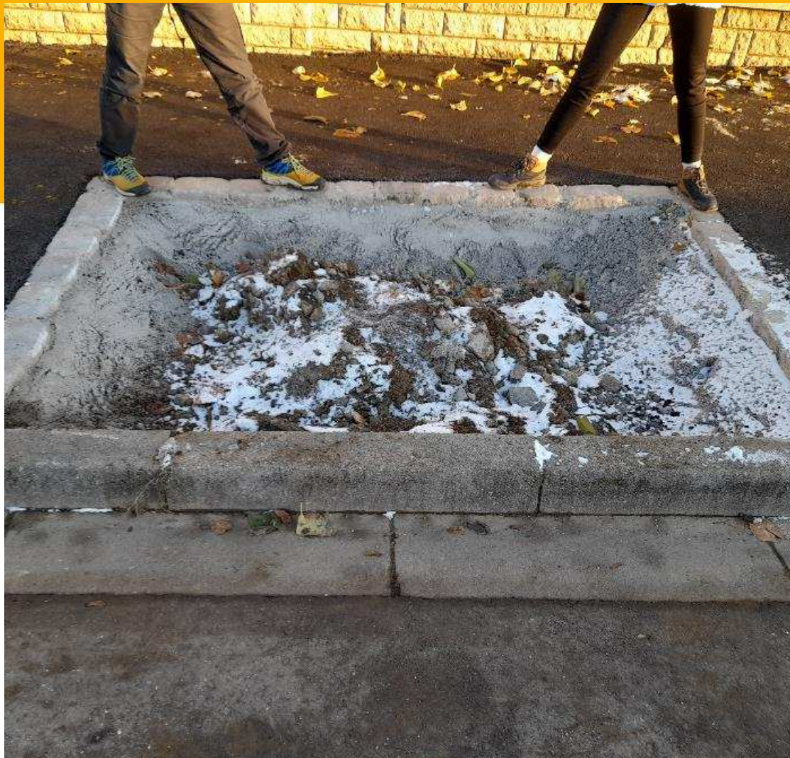
Fosse de plantation trop bétonnée
