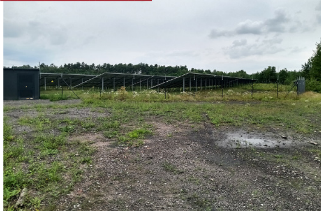
Centrale photovoltaïque sur les anciennes friches charbonnières à Diesen
